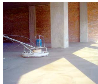
Obytný dům Kijev, Zvukově a tepelně-izolační podlaha ze SIOPOR-BETONu, ( \rho=400 \text{ kg.m}^{-3} ), celková upravená plocha 40 000 m 2
